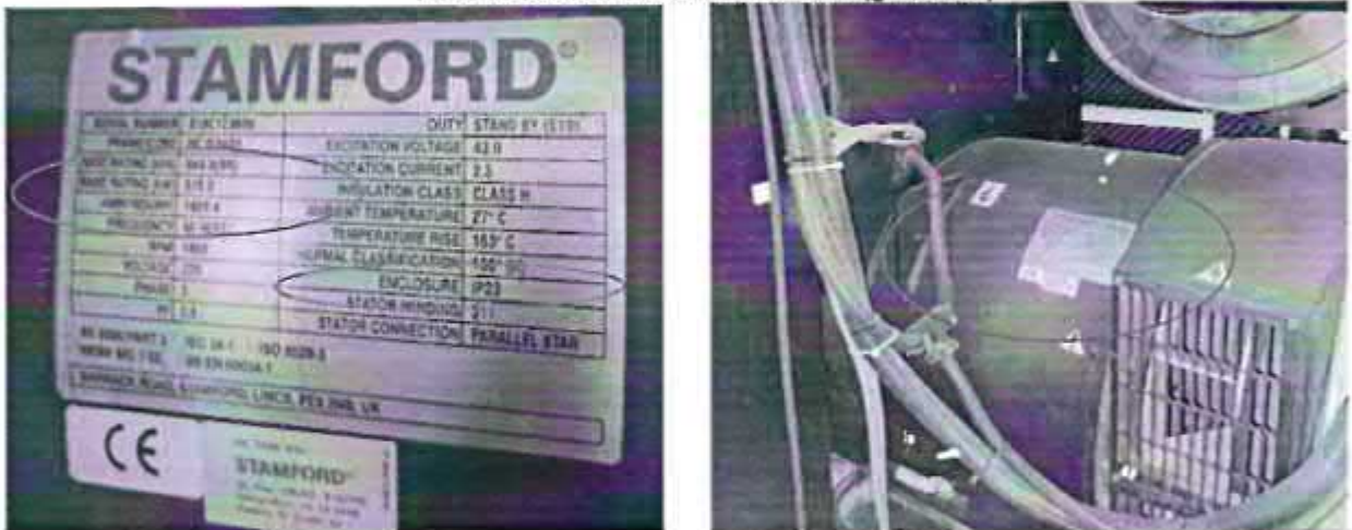
Imágenes n.º 1 y 2 Placa de características del Alternador (generador)
